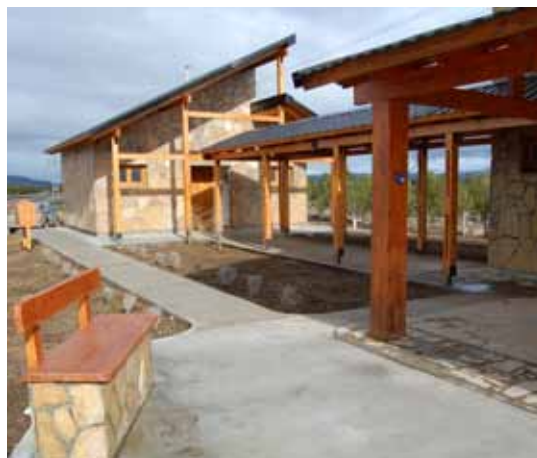
Arr. : Obra Viejo Expreso Patagónico. Izq. Ab.: Señalización P.N. Lago Puelo. Der. Ab.: Construcción centro de visitantes y portal de acceso al corredor. Fotos: Ministerio de turismo..
